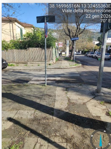
PAVIMENTAZIONE SCONNESSA/ ASSENZA DI RAMPA
