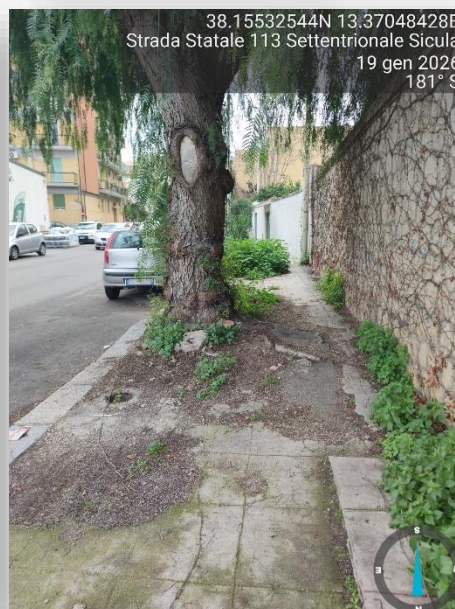
PAVIMENTAZIONE SCONNESSA/ OSTACOLI
