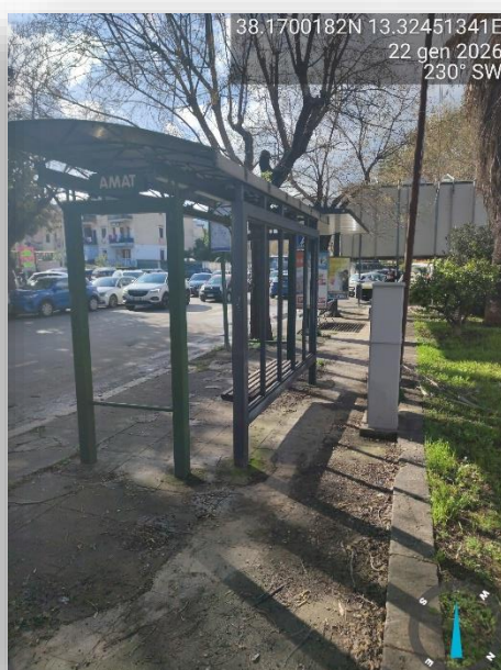
PAVIMENTAZIONE SCONNESSA/ OSTACOLI
