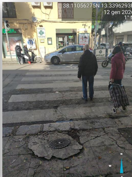
PAVIMENTAZIONE SCONNESSA/ OSTACOLI
