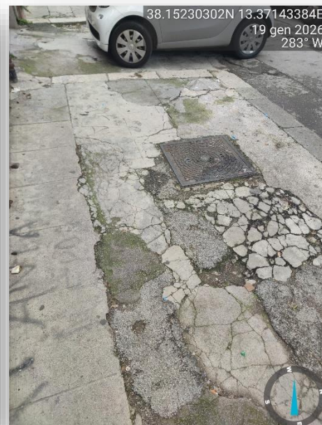
PAVIMENTAZIONE SCONNESSA/ OSTACOLO
