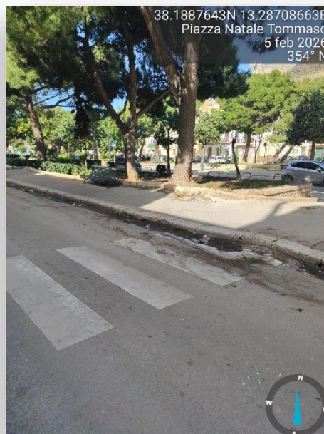
ASSENZA DI RAMPA
