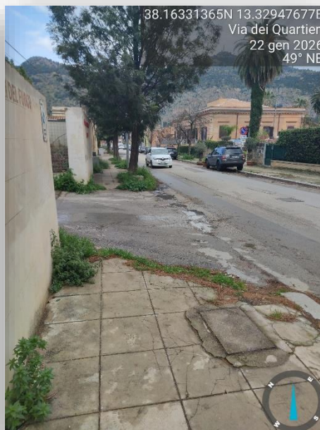
PAVIMENTAZIONE SCONNESSA/ OSTACOLI
