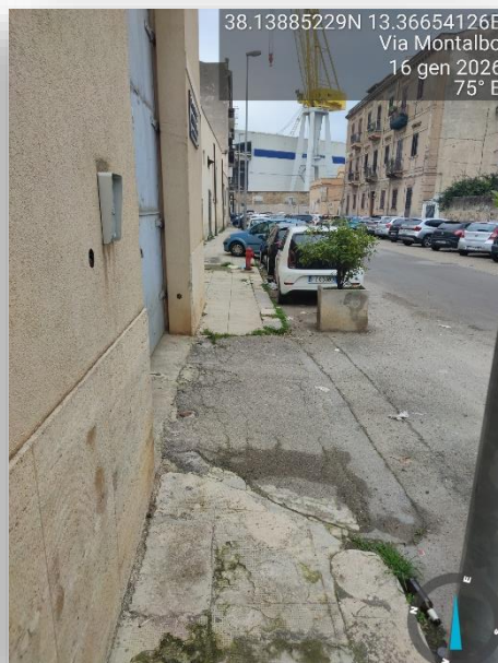
PAVIMENTAZIONE SCONNESSA/ DISLIVELLO
