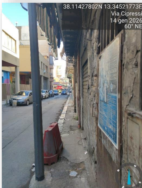
PAVIMENTAZIONE SCONNESSA/OSTACOLI / LARGHEZZA NON ADEGUATA
