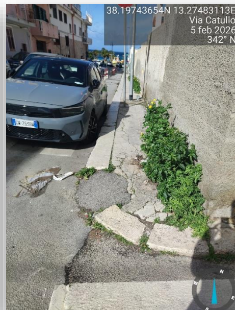
PAVIMENTAZIONE SCONNESSA/ OSTACOLI/ LARGHEZZA INADEGUATA
