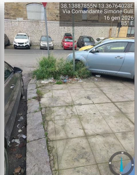
PAVIMENTAZIONE SCONNESSA/ OSTACOLO
