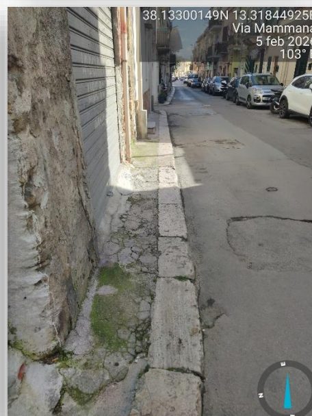
PAVIMENTAZIONE SCONNESSA/ LARGHEZZA INADEGUATA
