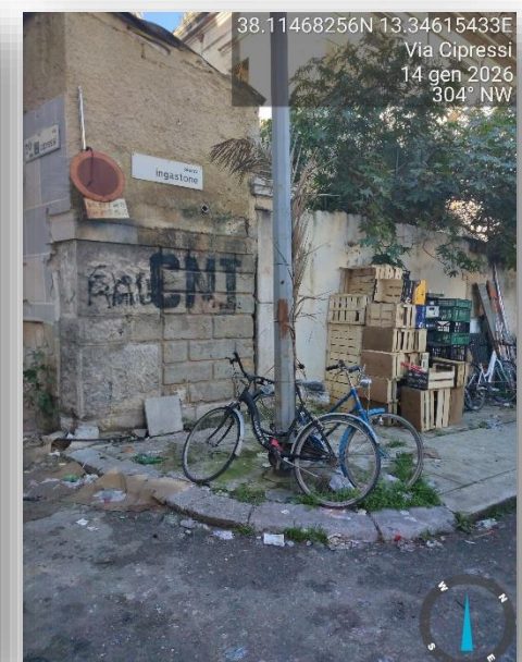
DISLIVELLO/ PAVIMENTAZIONE SCONNESSA/ OSTACOLI
