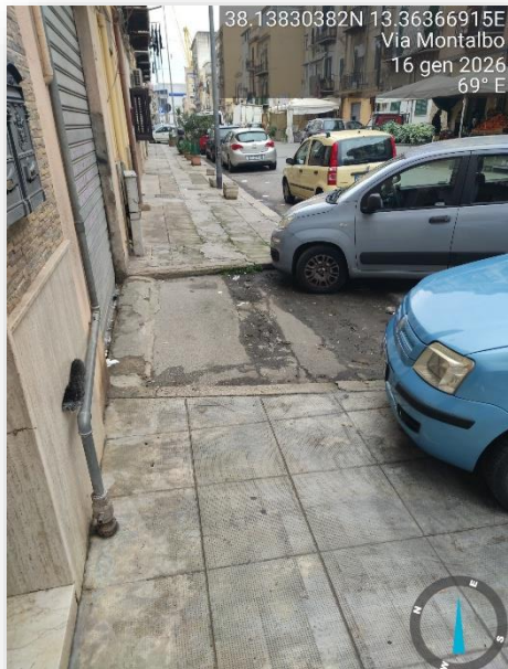
DISLIVELLO/ RAMPA INADEGUATA
