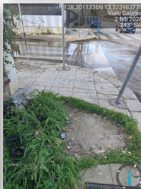
PAVIMENTAZIONE SCONNESSA/ OSTACOLI
