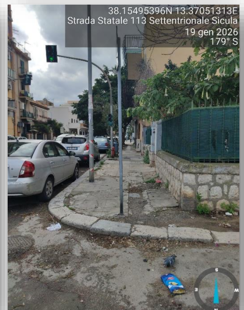
PAVIMENTAZIONE SCONNESSA/ OSTACOLI/ DISLIVELLO
