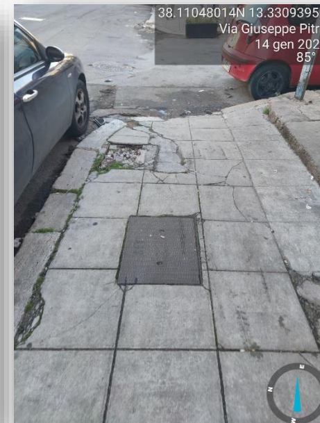
PAVIMENTAZIONE SCONNESSA/ OSTACOLO
