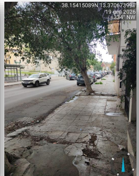
PAVIMENTAZIONE SCONNESSA/ OSTACOLI
