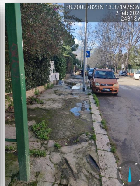
PAVIMENTAZIONE SCONNESSA/ OSTACOLI
