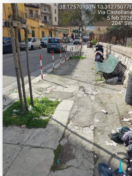
PAVIMENTAZIONE SCONNESSA/ OSTACOLI
