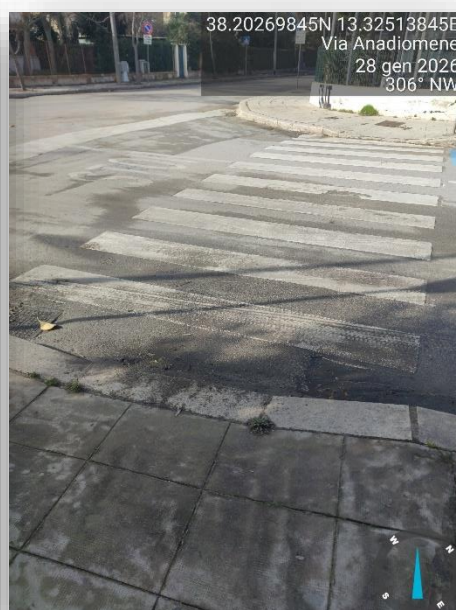
ATTRAVERSAMENTO NON IDONEO
