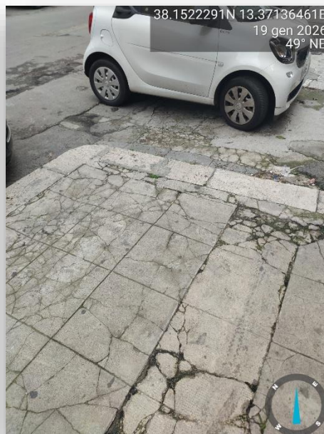
PAVIMENTAZIONE SCONNESSA /DISLIVELLO
