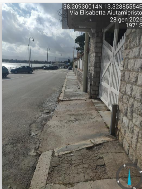
PAVIMENTAZIONE SCONNESSA/ DISLIVELLO
