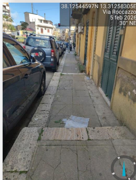
GRADINO/ ASSENZA DI RAMPA
