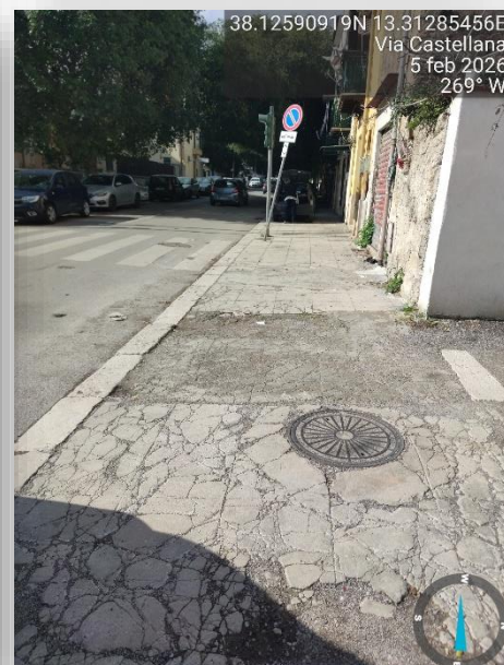
PAVIMENTAZIONE SCONNESSA/ OSTACOLI
