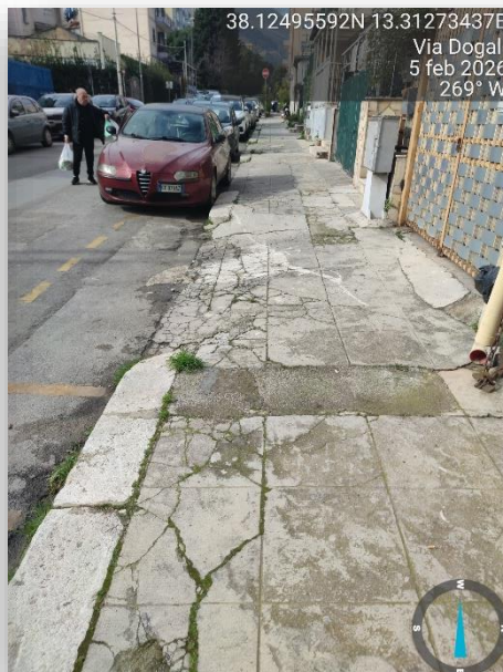
PAVIMENTAZIONE SCONNESSA/ DISLIVELLO
