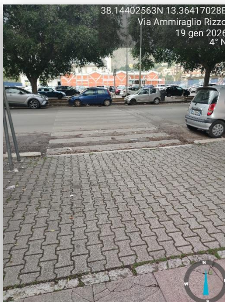
DISLIVELLO/ RAMPA NON ADEGUATA
