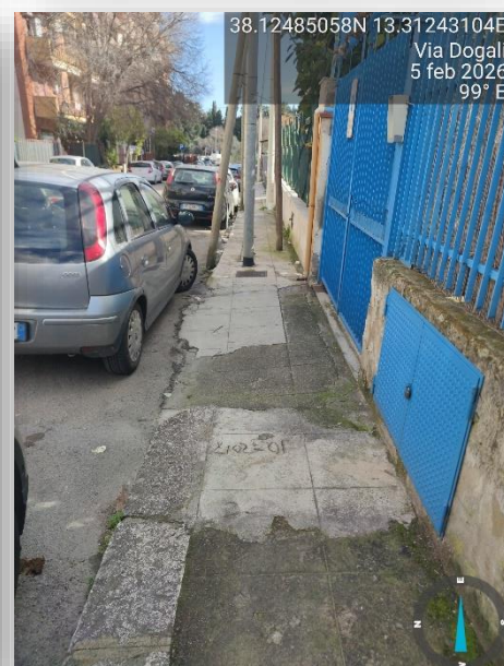
PAVIMENTAZIONE SCONNESSA/ OSTACOLI
