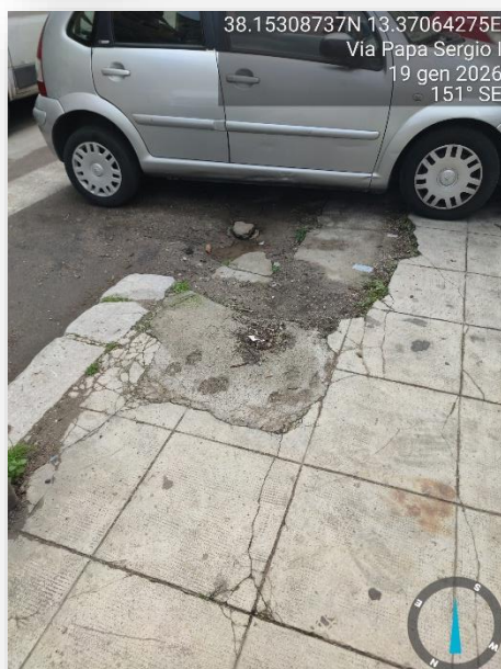
PAVIMENTAZIONE SCONNESSA/ ASSENZA RAMPA
