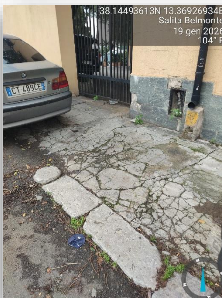
PAVIMENTAZIONE SCONNESSA /DISLIVELLO
