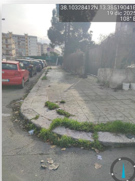
ATTRAVERSAMENTO NON ADEGUATO
