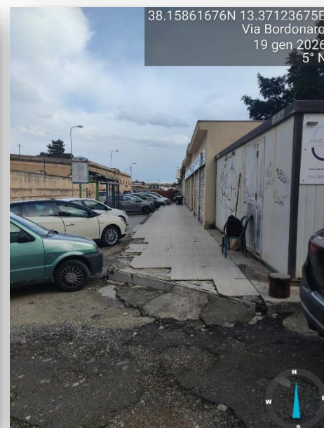
PAVIMENTAZIONE NON IDONEA E DISLIVELLO
