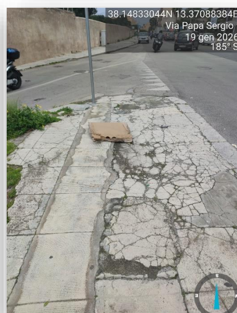
PAVIMENTAZIONE NON IDONEA
