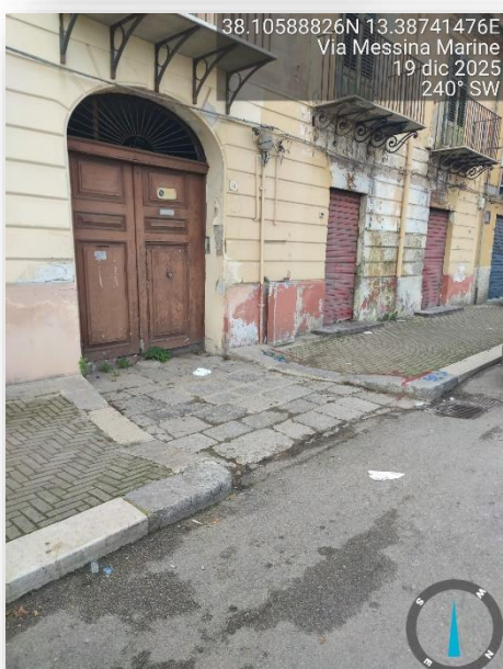
PAVIMENTAZIONE NON IDONEA E DISLIVELLO
