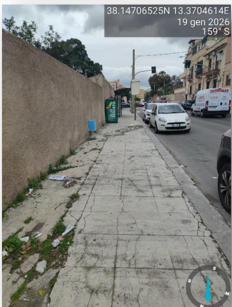
PAVIMENTAZIONE NON IDONEA
