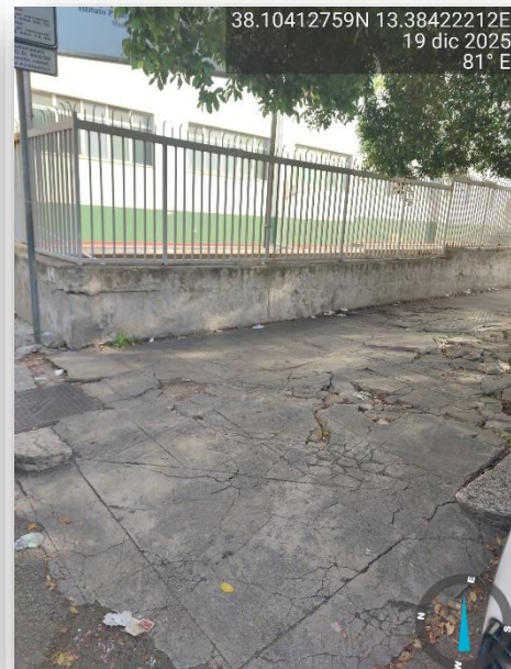
PAVIMENTAZIONE NON IDONEA
