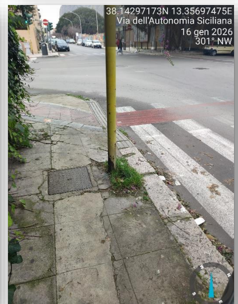
ATTRAVERSAMENTO NON ADEGUATO
