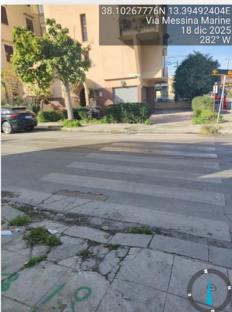
ATTRAVERSAMENTO NON ADEGUATO
