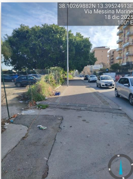
PAVIMENTAZIONE NON IDONEA
