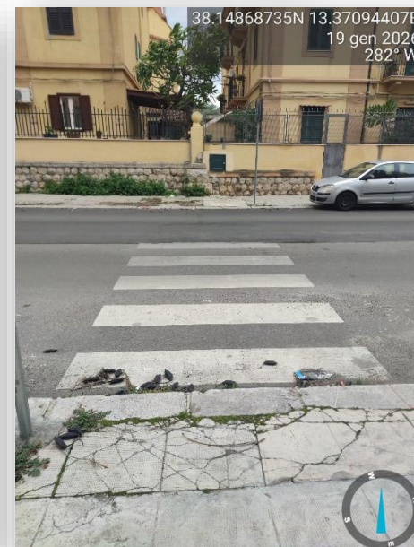
ATTRAVERSAMENTO NON ADEGUATO
