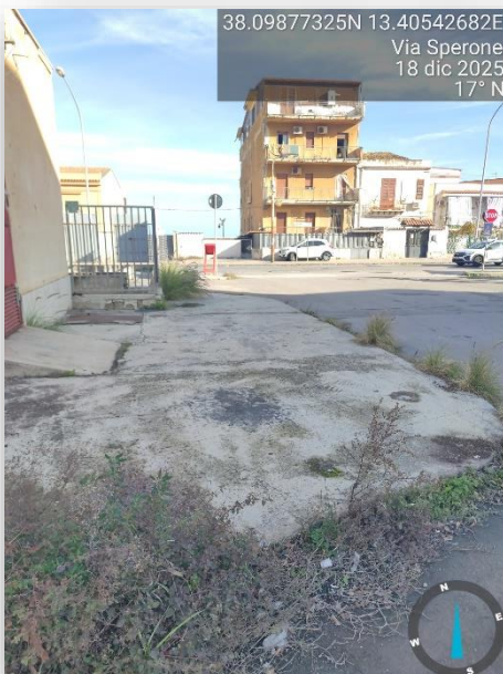
PAVIMENTAZIONE NON IDONEA
