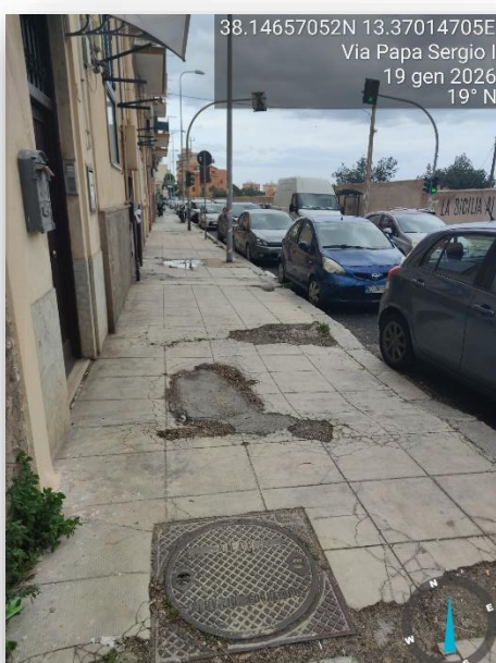
PAVIMENTAZIONE NON IDONEA
