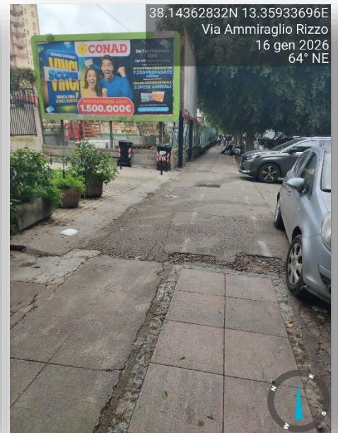
PAVIMENTAZIONE NON IDONEA
