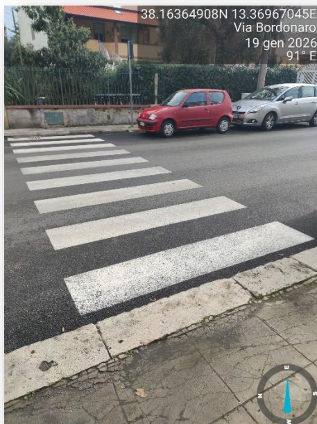
ATTRAVERSAMENTO NON ADEGUATO
