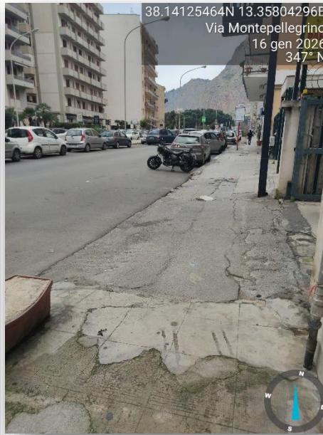
PAVIMENTAZIONE NON IDONEA
