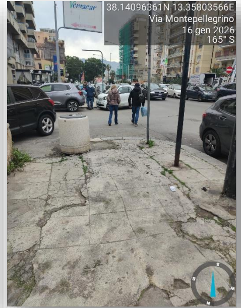
ATTRAVERSAMENTO NON ADEGUATO
