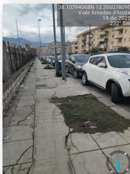
PAVIMENTAZIONE NON IDONEA
