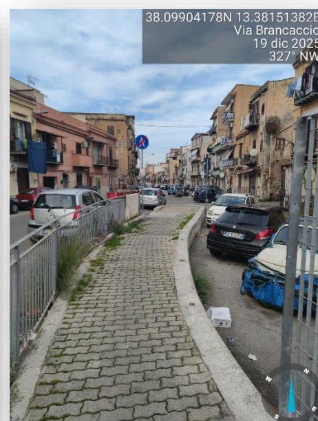
PAVIMENTAZIONE NON IDONEA
