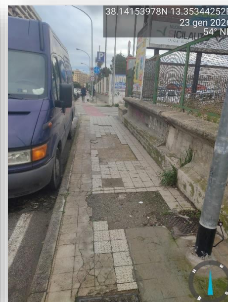
PAVIMENTAZIONE NON IDONEA
