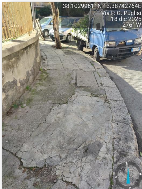
PAVIMENTAZIONE NON IDONEA E OSTACOLI
