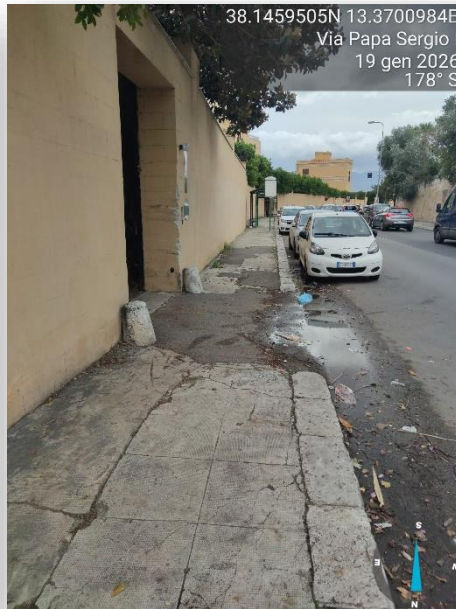
PAVIMENTAZIONE NON IDONEA
