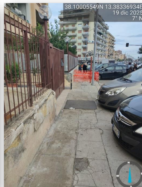
PAVIMENTAZIONE NON IDONEA E OSTACOLI
