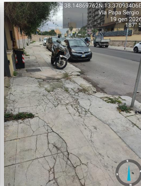
PAVIMENTAZIONE NON IDONEA
