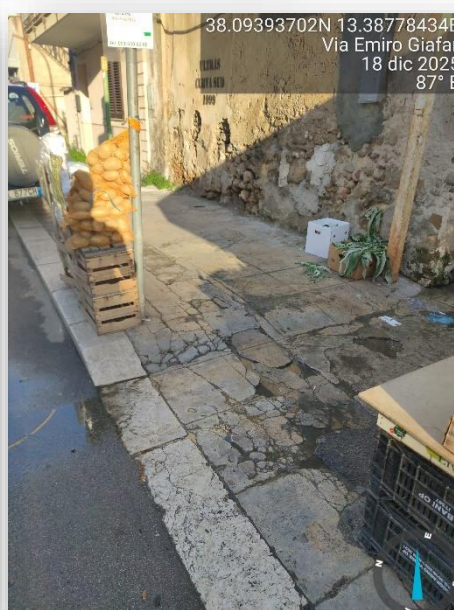
PAVIMENTAZIONE NON IDONEA
