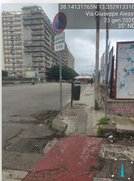
PAVIMENTAZIONE NON IDONEA E OSTACOLI
