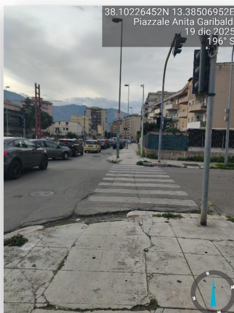
ATTRAVERSAMENTO NON ADEGUATO
