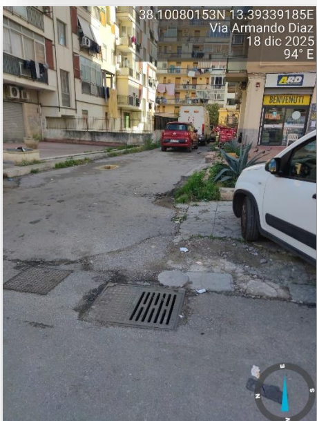
PERCORSO PEDONALE ASSENTE
