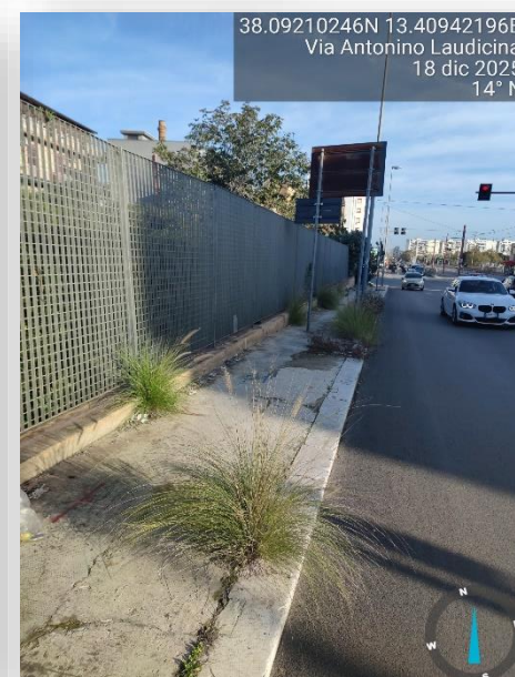
PAVIMENTAZIONE NON IDONEA E DISLIVELLO
