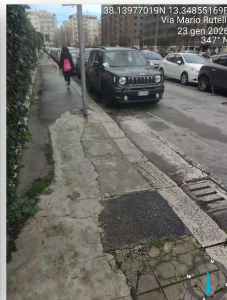
PAVIMENTAZIONE NON IDONEA
