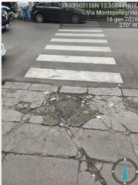
ATTRAVERSAMENTO NON ADEGUATO
