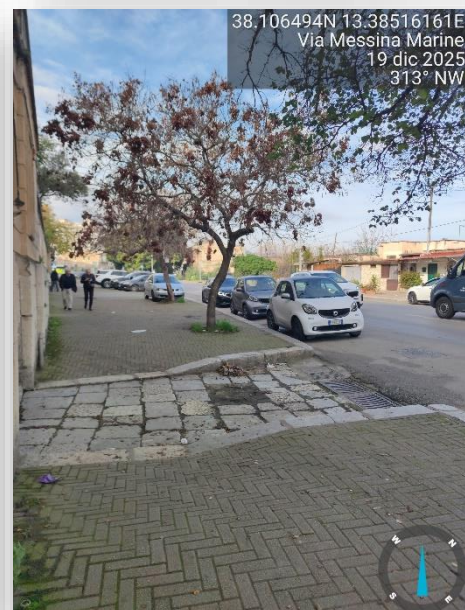
PAVIMENTAZIONE NON IDONEA E DISLIVELLO
