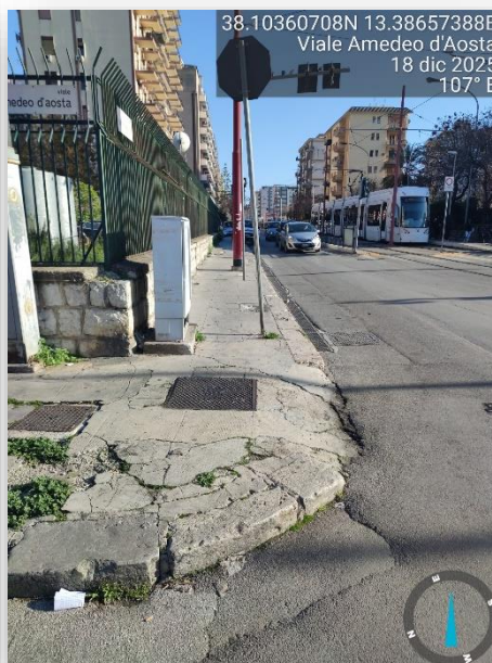
ATTRAVERSAMENTO NON ADEGUATO
