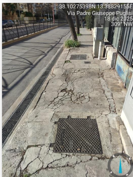
PAVIMENTAZIONE NON IDONEA E OSTACOLI
