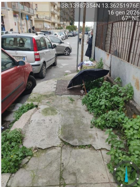
PAVIMENTAZIONE NON IDONEA E OSTACOLI
