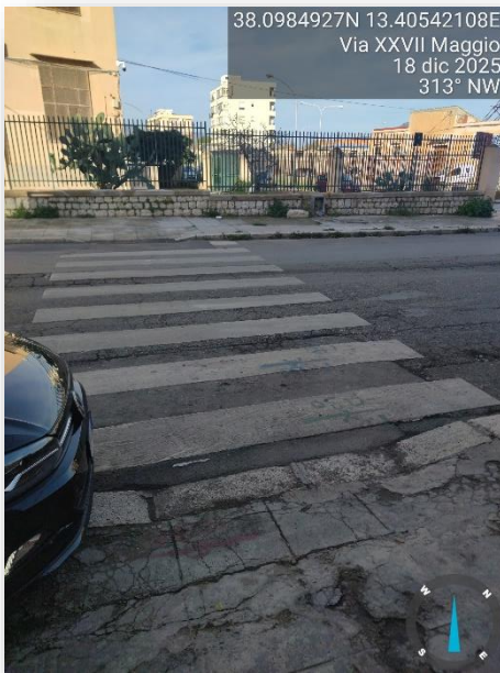
ATTRAVERSAMENTO NON ADEGUATO
