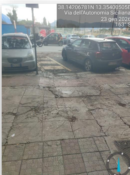
PAVIMENTAZIONE NON IDONEA
