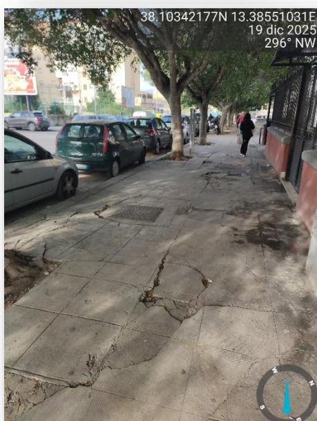
PAVIMENTAZIONE NON IDONEA
