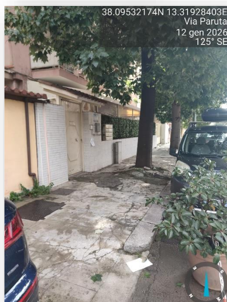
PAVIMENTAZIONE NON IDONEA E OSTACOLI
