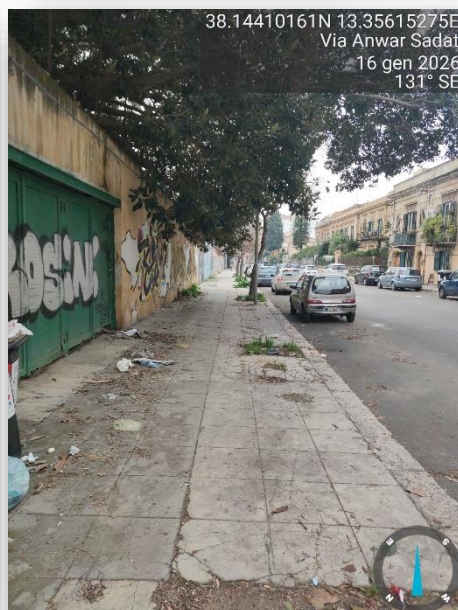
PAVIMENTAZIONE NON IDONEA
