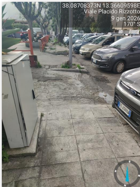
ATTRAVERSAMENTO NON ADEGUATO
