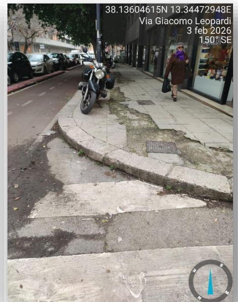
ATTRAVERSAMENTO NON ADEGUATO
