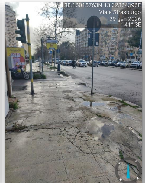
ATTRAVERSAMENTO NON ADEGUATO
