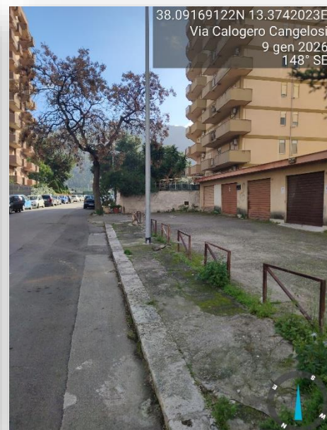
PAVIMENTAZIONE NON IDONEA
