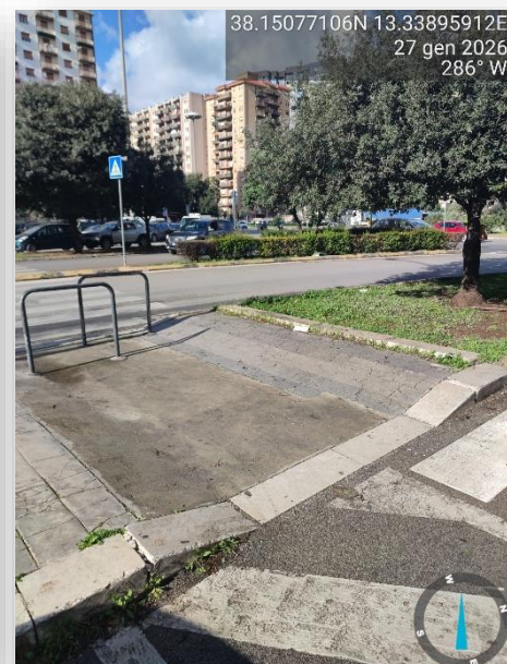
ATTRAVERSAMENTO NON ADEGUATO
