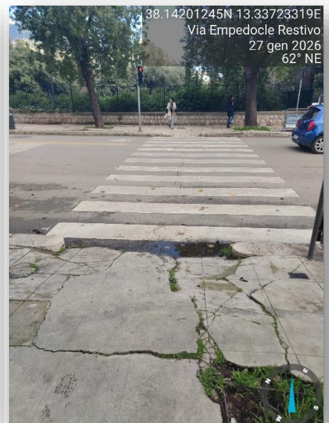
ATTRAVERSAMENTO NON IDONEO
