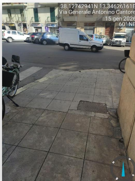
ATTRAVERSAMENTO NON ADEGUATO
