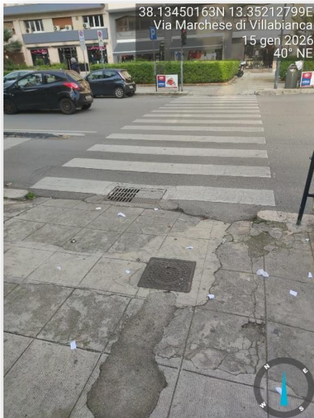
ATTRAVERSAMENTO NON ADEGUATO
