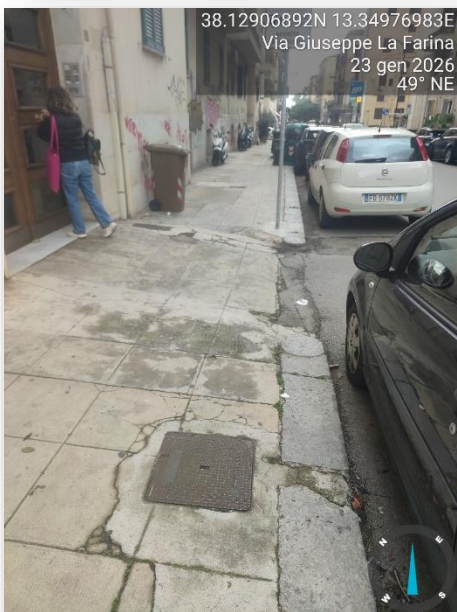
PAVIMENTAZIONE SCONNESSA E DISLIVELLI
