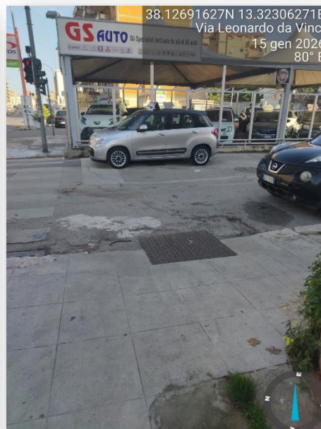
ATTRAVERSAMENTO NON ADEGUATO
