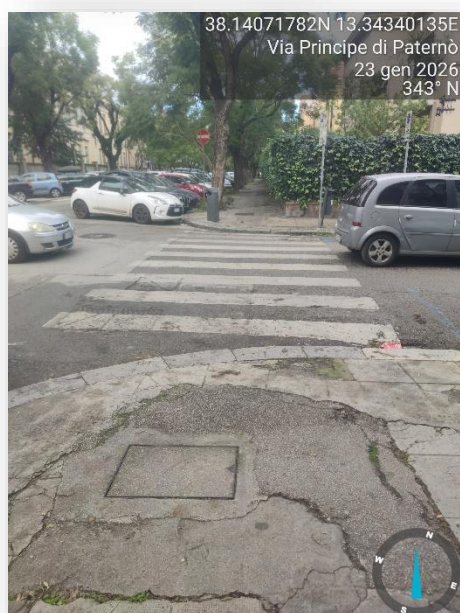
ATTRAVERSAMENTO NON IDONEO
