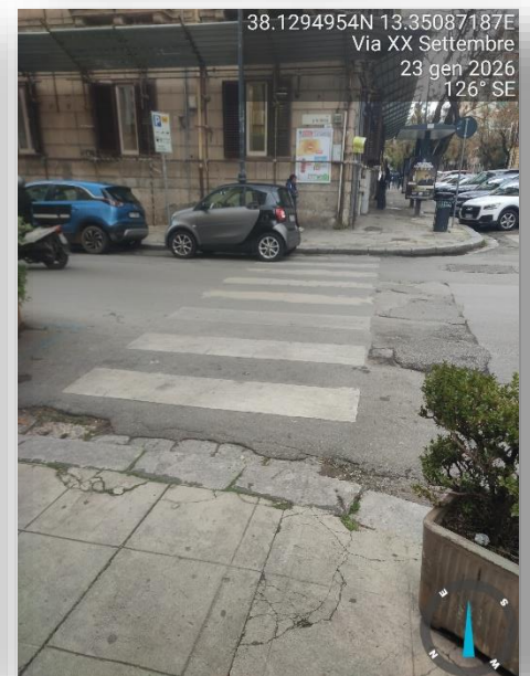
ATTRAVERSAMENTO NON IDONEO
