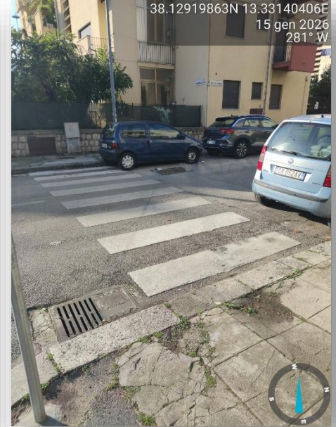
ATTRAVERSAMENTO NON ADEGUATO
