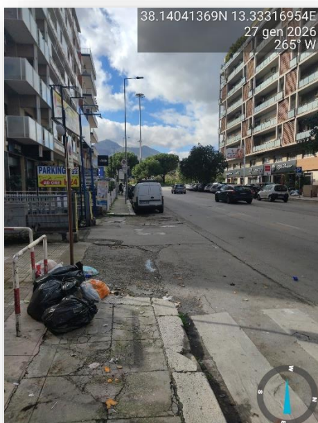
PAVIMENTAZIONE SCONNESSA E DISLIVELLI
