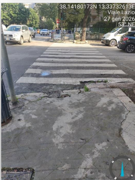
ATTRAVERSAMENTO NON IDONEO
