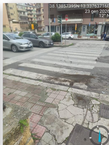
ATTRAVERSAMENTO NON IDONEO
