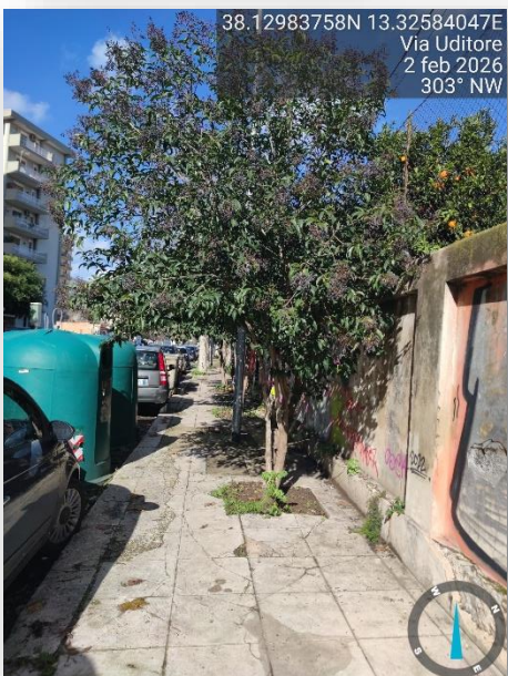
OSTACOLI SU PAVIMENTAZIONE SCONNESSA
