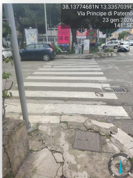
ATTRAVERSAMENTO NON IDONEO
