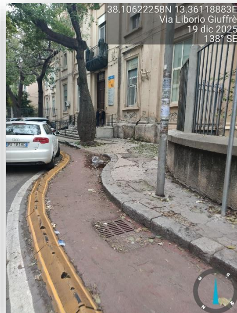
ATTRAVERSAMENTO NON IDONEO
