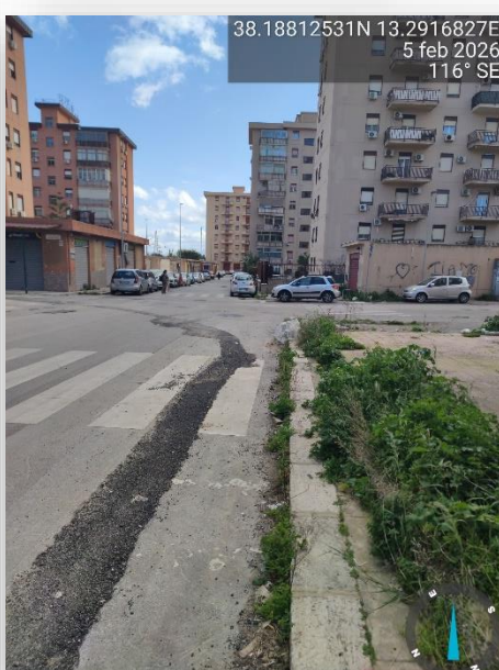
ATTRAVERSAMENTO NON ADEGUATO
