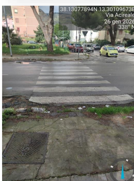
ATTRAVERSAMENTO NON ADEGUATO
