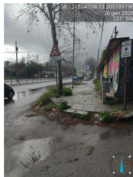
ATTRAVERSAMENTO NON ADEGUATO
