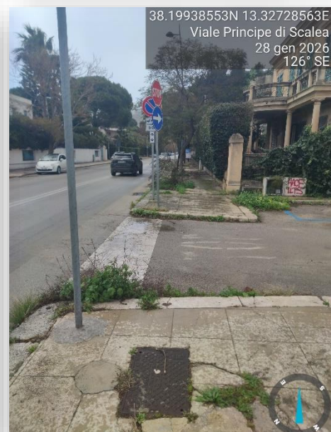
ATTRAVERSAMENTO NON ADEGUATO
