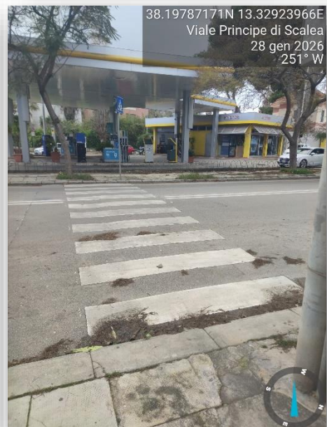
ATTRAVERSAMENTO NON ADEGUATO
