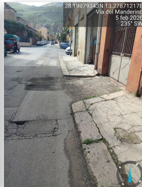
ATTRAVERSAMENTO NON ADEGUATO
