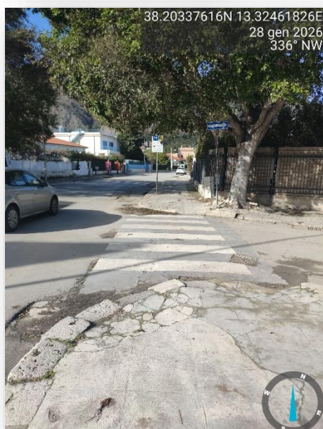
ATTRAVERSAMENTO NON ADEGUATO
