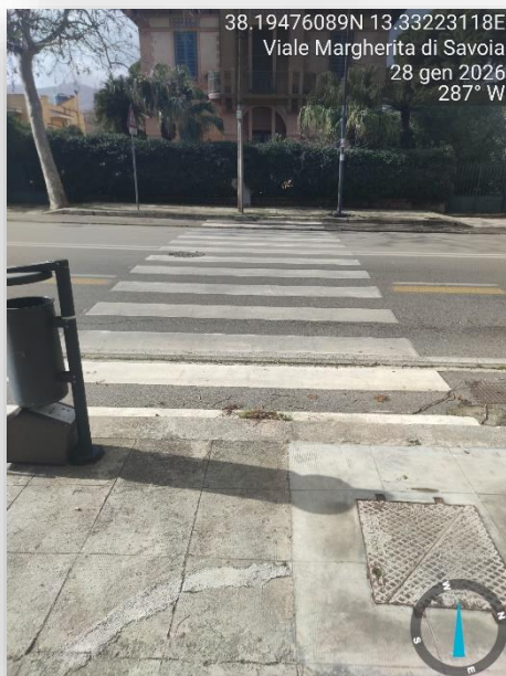
ATTRAVERSAMENTO NON ADEGUATO
