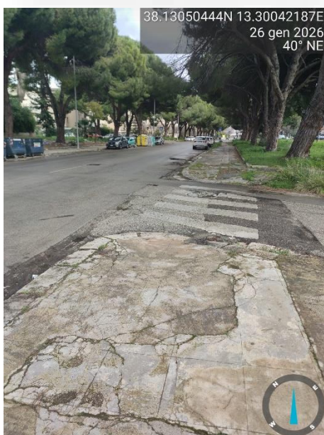
ATTRAVERSAMENTO NON ADEGUATO
