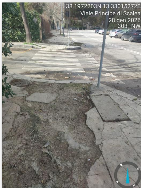
ATTRAVERSAMENTO NON ADEGUATO
