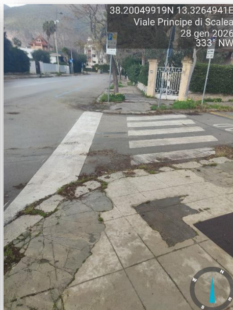
ATTRAVERSAMENTO NON ADEGUATO
