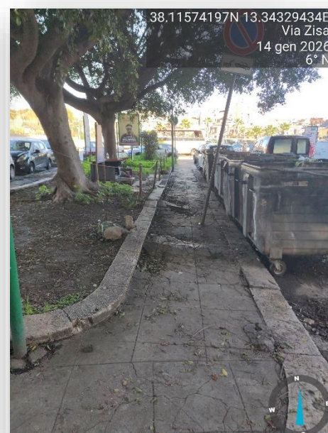
OSTACOLI SU PAVIMENTAZIONE SCONNESSA
