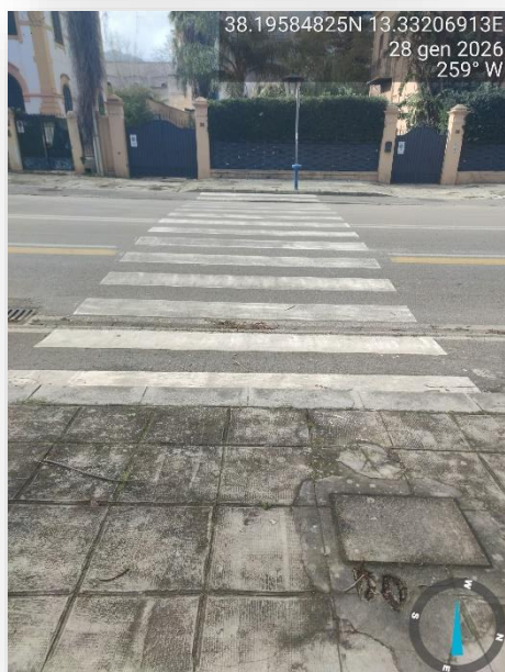
ATTRAVERSAMENTO NON ADEGUATO
