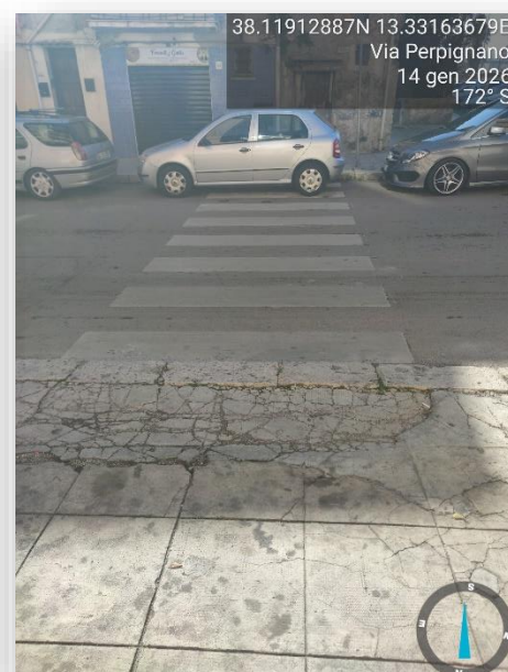
ATTRAVERSAMENTO NON ADEGUATO
