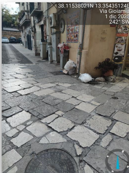
PAVIMENTAZIONE SCONNESSA/ OSTACOLI
