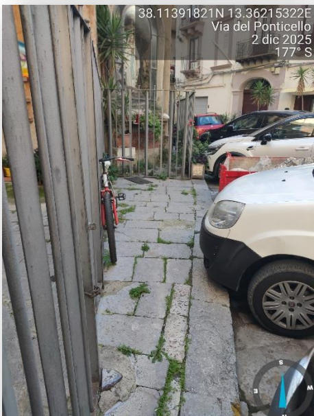
PAVIMENTAZIONE SCONNESSA/ OSTACOLI/ LARGHEZZA NON ADEGUATA
