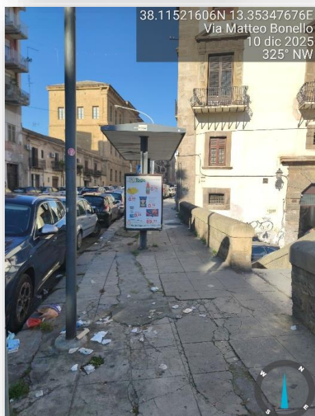
PAVIMENTAZIONE SCONNESSA/ OSTACOLI
