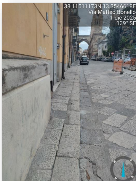
PERCORSO PEDONALE NON DEFINITO/ PAVIMENTAZIONE SCONNESSA
