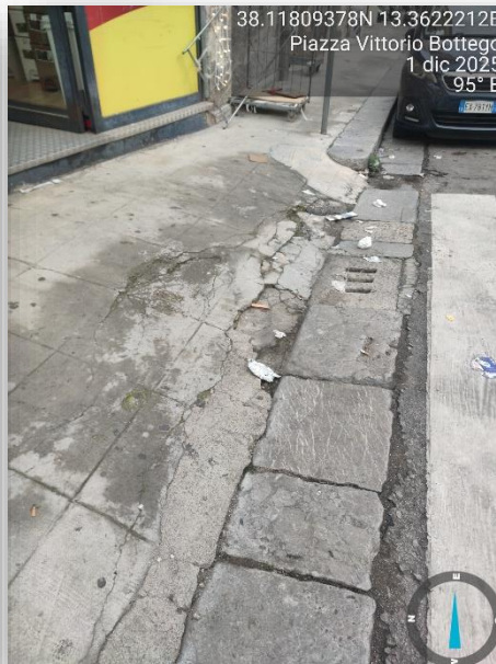
PAVIMENTAZIONE SCONNESSA/ OSTACOLI/ DISLIVELLO
