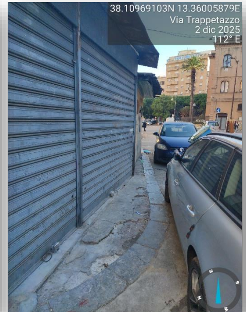
PAVIMENTAZIONE SCONNESSA/LARGHEZZA INADEGUATA
