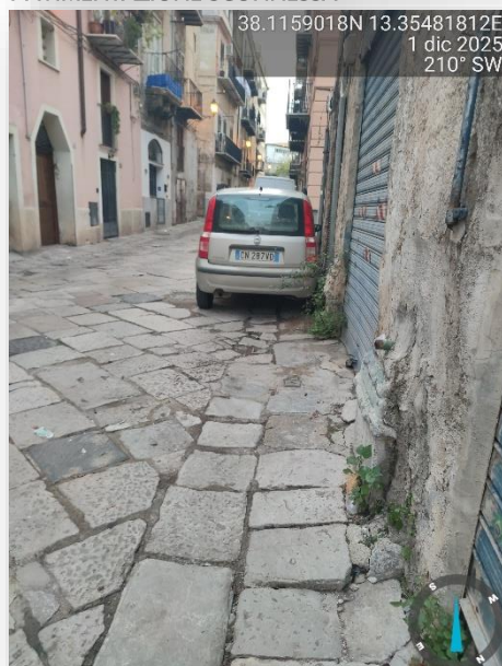
PAVIMENTAZIONE SCONNESSA/ MANCANZA PERCORSO PEDONALE
