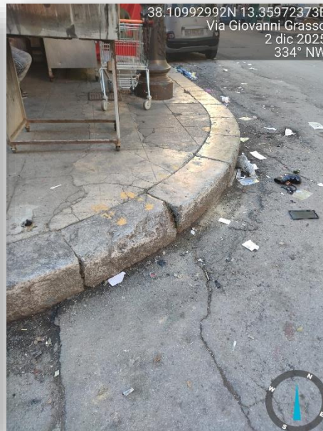
RAMPA NON ADEGUATA
