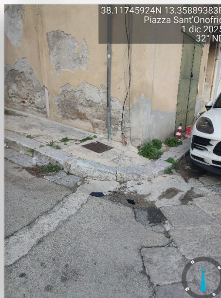
PAVIMENTAZIONE SCONNESSA/ DISLIVELLO/ MANCANZA PERCORSO PEDONALE
