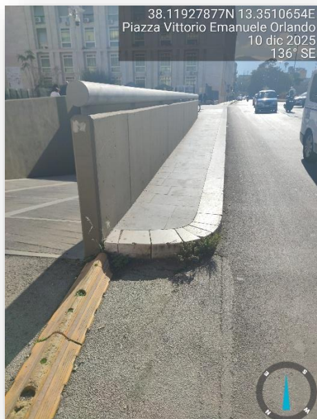
DISLIVELLO/ MANCANZA RAMPA
