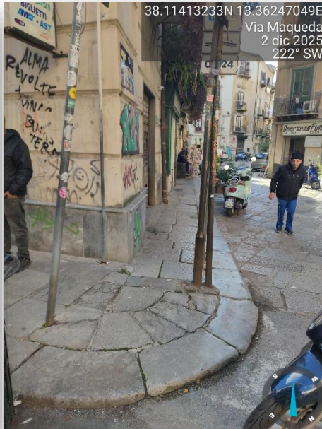
PAVIMENTAZIONE SCONNESSA/ DISLIVELLO/ OSTACOLI
