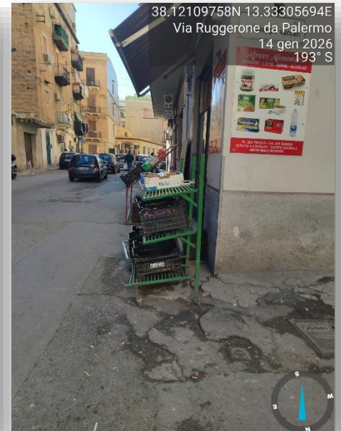
ASSENZA PERCORSO PEDONALE / OSTACOLI
