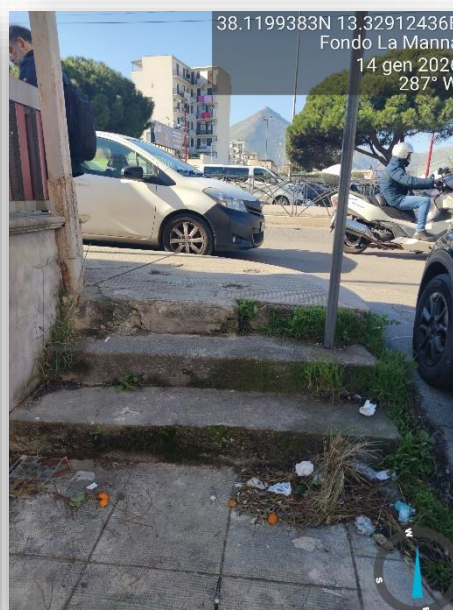
GRADINI/ ASSENZA DI RAMPA
