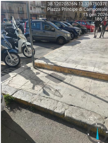
GRADINO/ ASSENZA DI RAMPA
