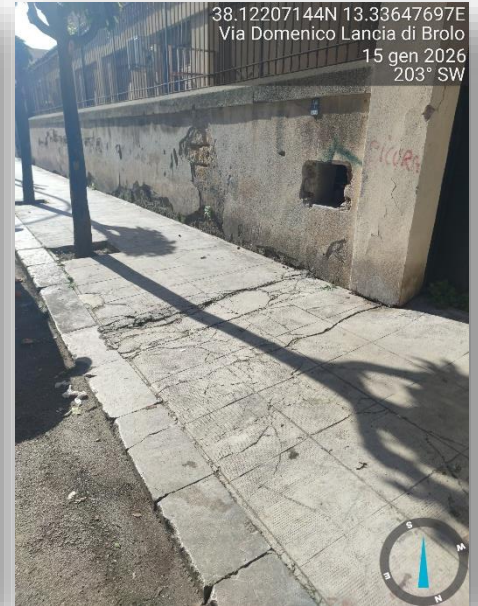
PAVIMENTAZIONE SCONNESSA/ OSTACOLI
