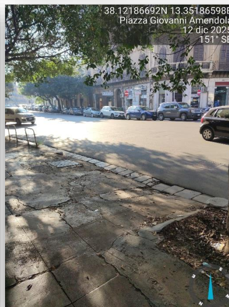
PAVIMENTAZIONE SCONNESSA/ OSTACOLI
