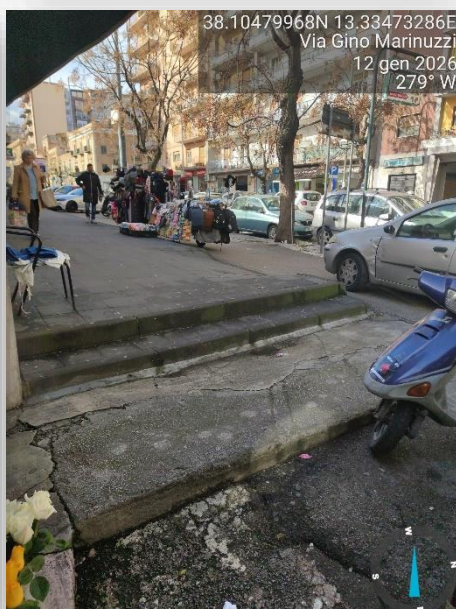
GRADINI/MANCANZA DI RAMPA
