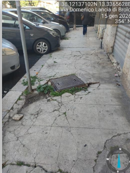
PAVIMENTAZIONE SCONNESSA/ OSTACOLI
