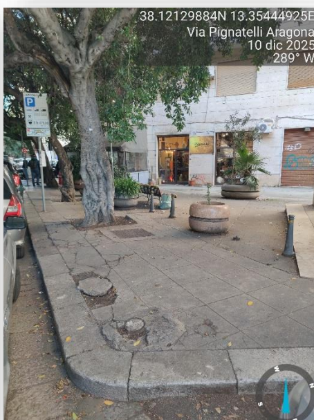
OSTACOLI/ PAVIMENTAZIONE DISSESTATA/ DISLIVELLO
