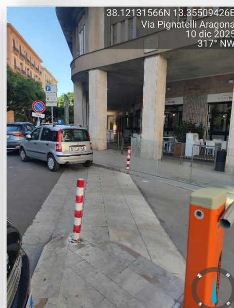
OSTACOLI/ MANCANZA RAMPA DI RACCORDO
