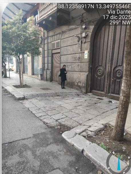
RAMPA NON ADEGUATA
