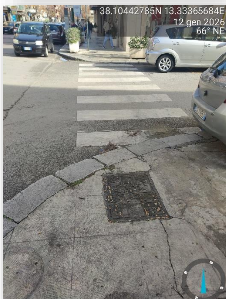
PAVIMENTAZIONE SCONNESSA/ OSTACOLI
