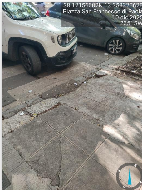
RAMPA NON ADEGUATA/PAVIMENTAZIONE SCONNESSA
