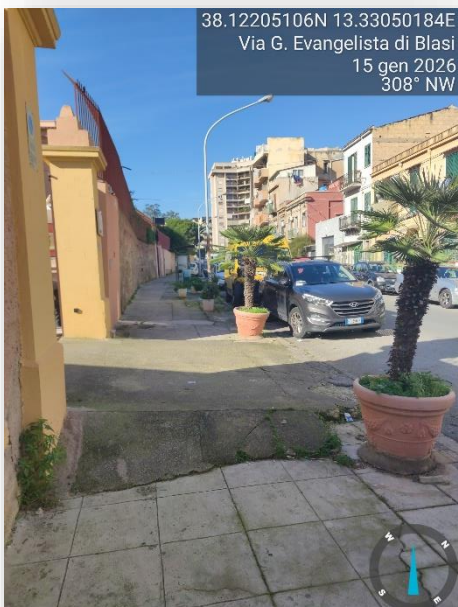
RAMPA NON ADEGUATA
