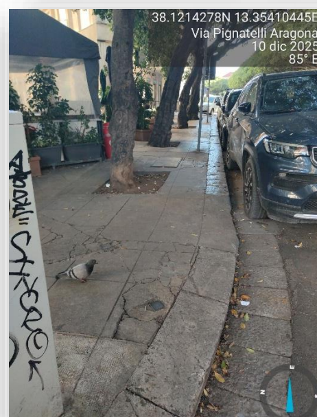
OSTACOLI/ PAVIMENTAZIONE DISSESTATA/ DISLIVELLO
