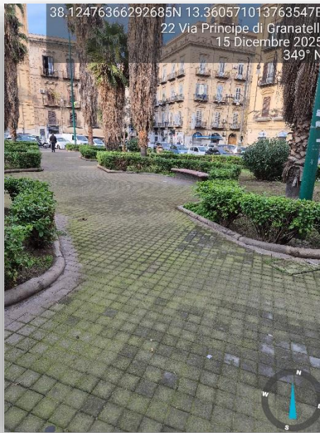
PAVIMENTAZIONE NON IDONEA
