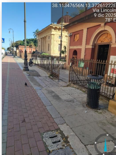
CORDOLO D'INGRESSO/PAVIMENTAZIONE SCONNESSA/OSTACOLI
