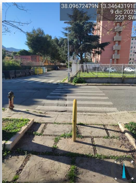
PAVIMENTAZIONE NON IDONEA
