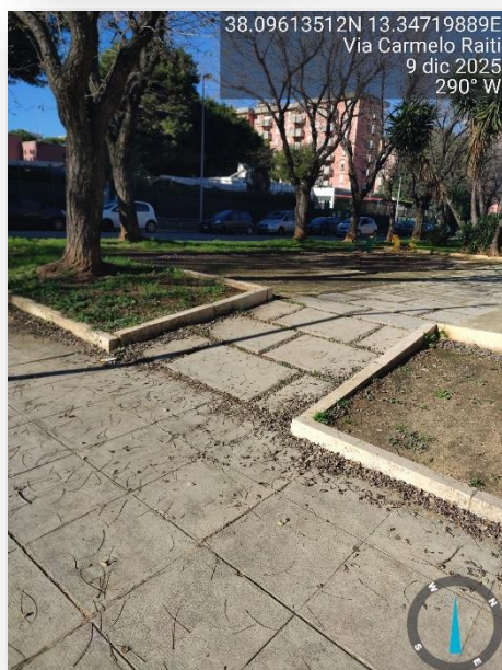
PAVIMENTAZIONE NON IDONEA
