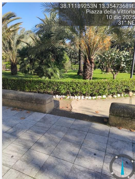
CORDOLO D'INGRESSO/PAVIMENTAZIONE SCONNESSA
