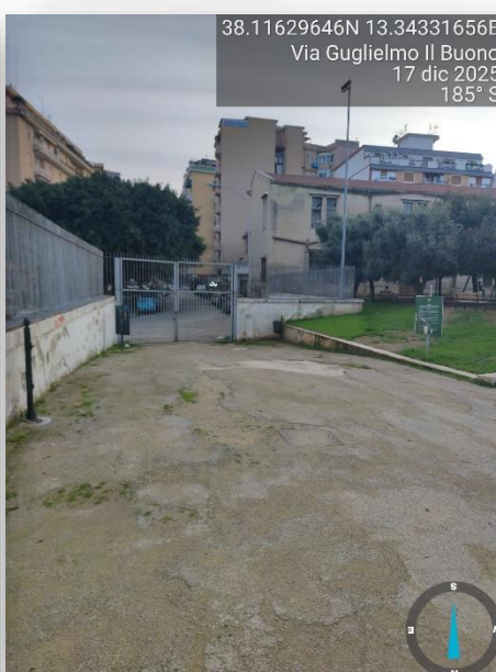
CORDOLO D'INGRESSO/SUPERFICIE IRREGOLARE
