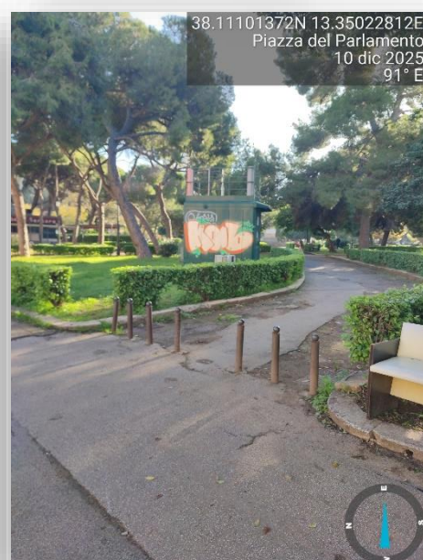
CORDOLO D'INGRESSO/OSTACOLO/PAVIMENTAZIONE SCONNESSA
