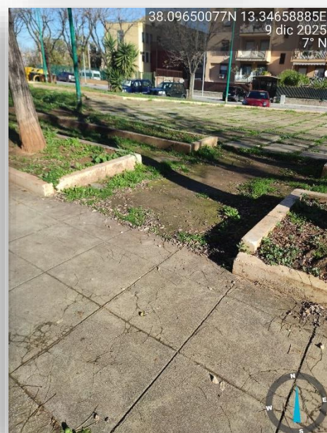
CORDOLO D'INGRESSO/SUPERFICIE IRREGOLARE
