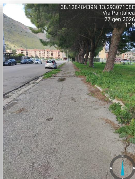
PAVIMENTAZIONE SCONNESSA E USURATA
