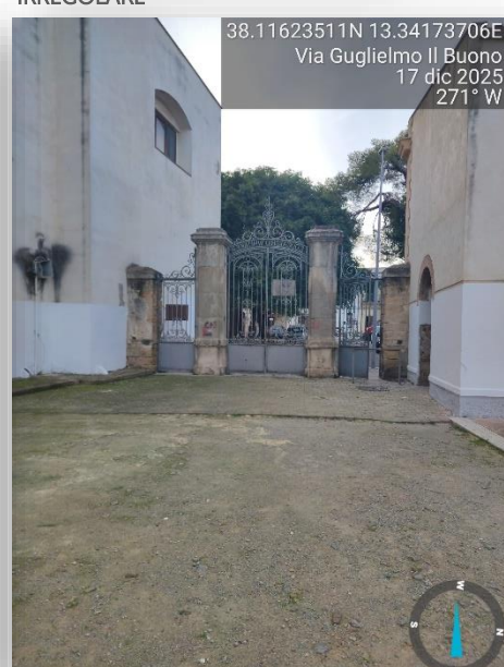
CORDOLO D'INGRESSO/SUPERFICIE IRREGOLARE
