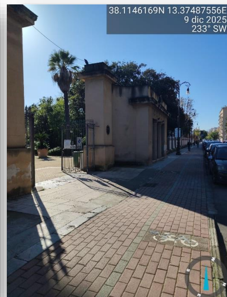
CORDOLO D'INGRESSO/PAVIMENTAZIONE SCONNESSA
