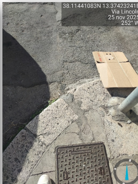
ATTRAVERSAMENTO NON ADEGUATO
