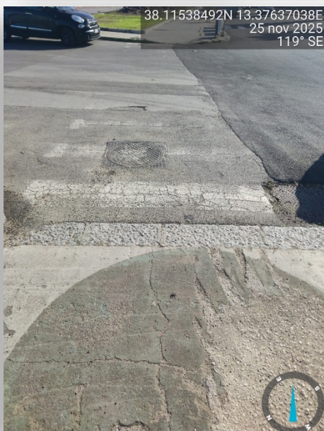
ATTRAVERSAMENTO NON ADEGUATO
