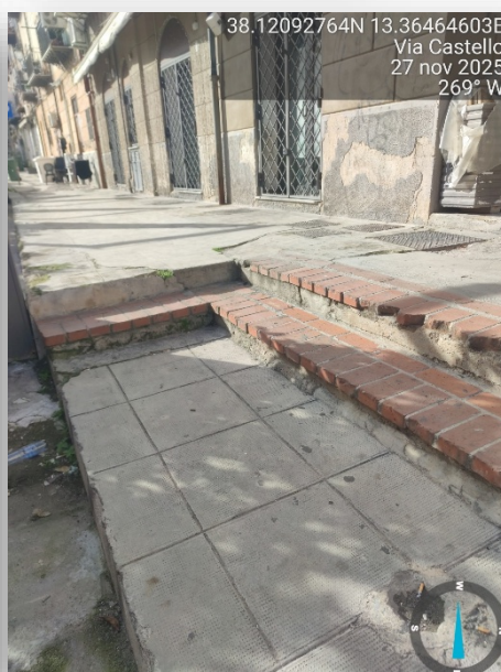
PRESENZA DI SCALE/PAVIMENTAZIONE SCONNESSA
