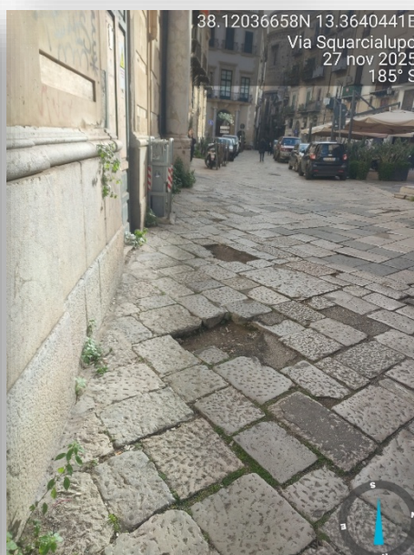
PERCORSO PEDONALE ASSENTE
