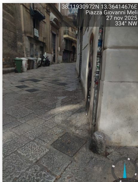
PERCORSO PEDONALE ASSENTE
