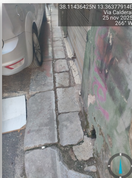
ASSENZA PERCORSO PEDONALE
