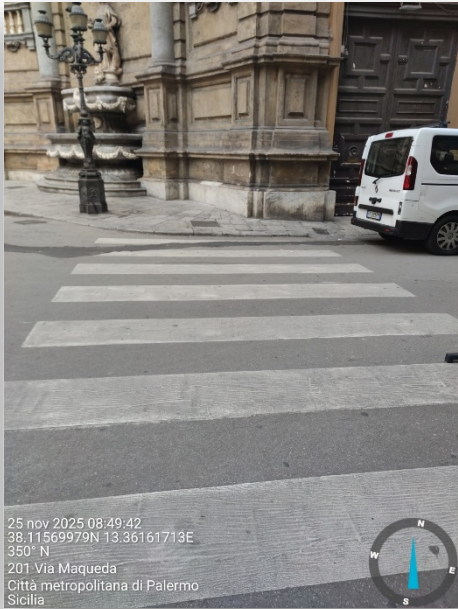
ATTRAVERSAMENTO NON ADEGUATO
