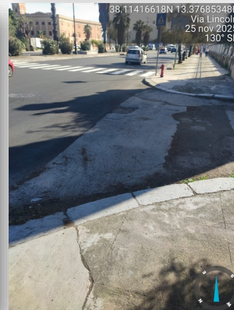
ATTRAVERSAMENTO NON ADEGUATO
