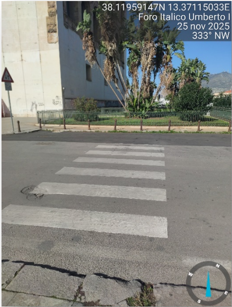
ATTRAVERSAMENTO NON ADEGUATO
