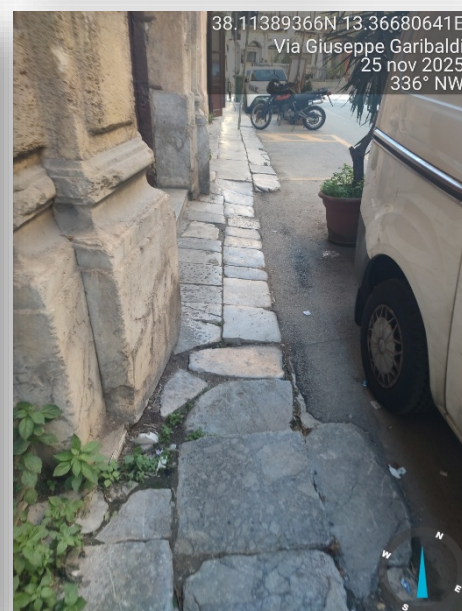
ASSENZA PERCORSO PEDONALE
