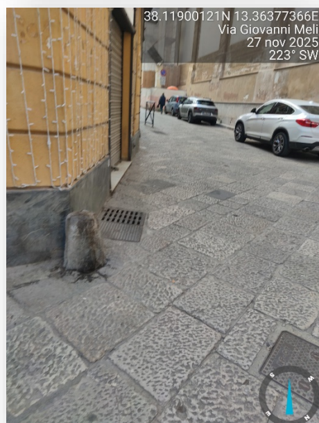
PERCORSO PEDONALE NON DELIMITATO
